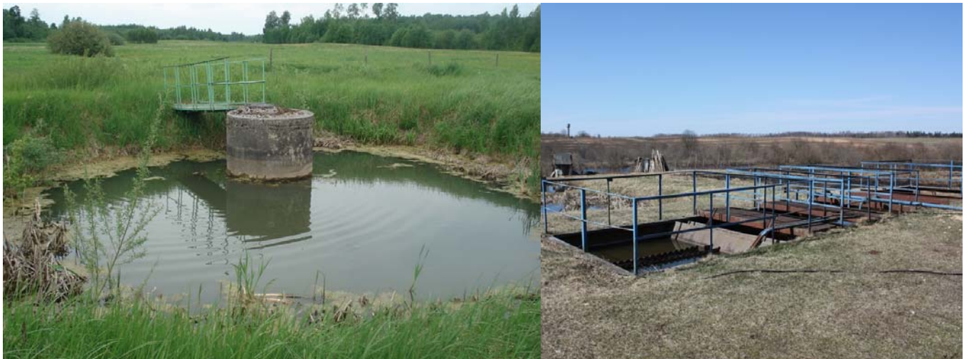
Attēls 3.5. Novecojušās notekūdeņu attīrīšanas iekārtas Ošānu un Sēllijas ciemos(Foto P. Grants)
